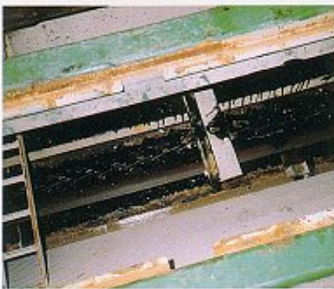
排泥コンベアーに給油したところ
