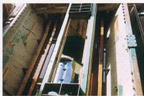
ポンプインベラーの確認
